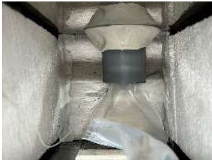
写真-2 塩ビ管端部の状態
